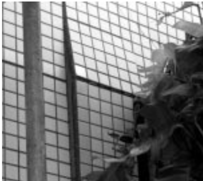
写真20 塩害によるタイルパネルの欠落
