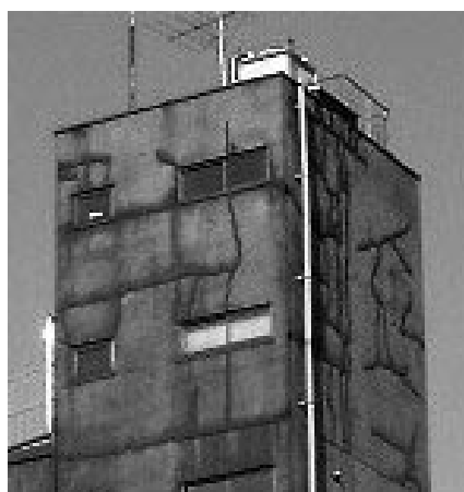
写真16 壁面全体のひび割れ
