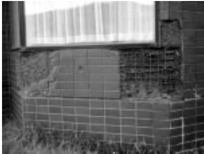
写真19 タイル目地からの浸水による爆裂
