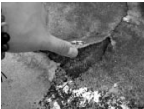
写真25 劣化し剥離した屋上シート
