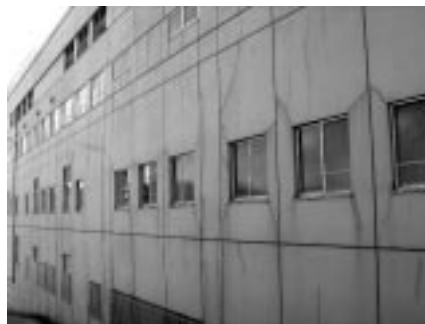
写真17 窓の開口部からのひび割れ
