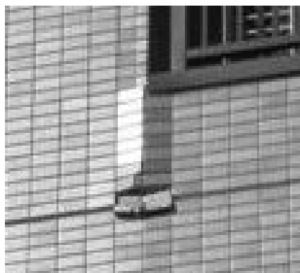
写真18 ベランダからの漏水によるタイルの剥離
