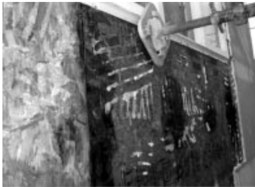
写真5 EFS表面からの浸水による水痕と腐食
