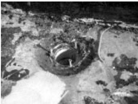
写真24 粉砕したドレイン周りの屋上シート
