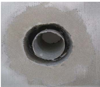
パイプ収まり
